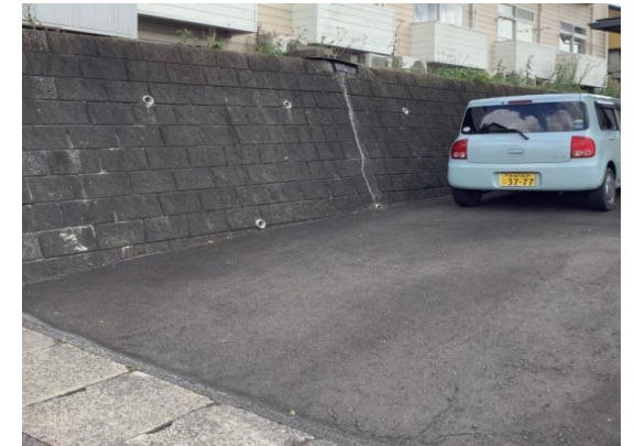
写真16 下流部擁壁に小規模の亀裂あり
