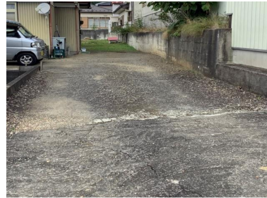
写真18 下流部宅地に状況
