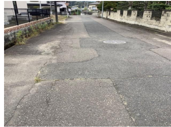
写真2 上流部路面に小規模の亀裂あり
