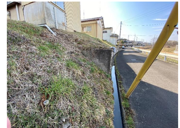
写真24 写真24下部の排水溝の滞水状況
