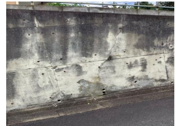
写真8 下流部擁壁に小規模の亀裂あり
