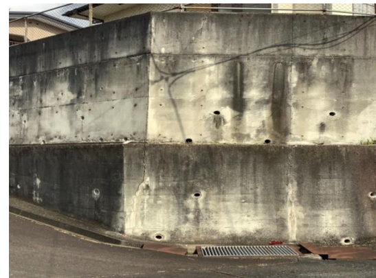
写真10 下流部擁壁の水抜き穴からの出水跡あり
