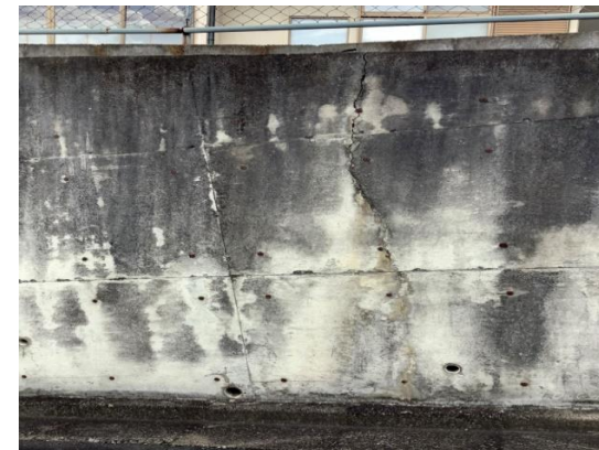
写真7 下流部擁壁に小規模の亀裂あり
