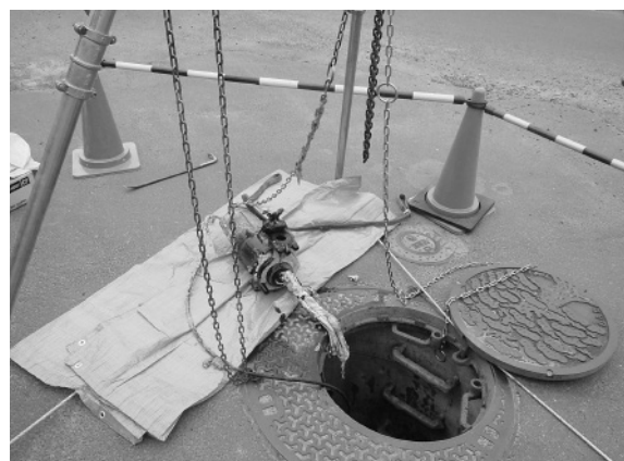
▲汚水ポンプにタオルがからみついている状態
