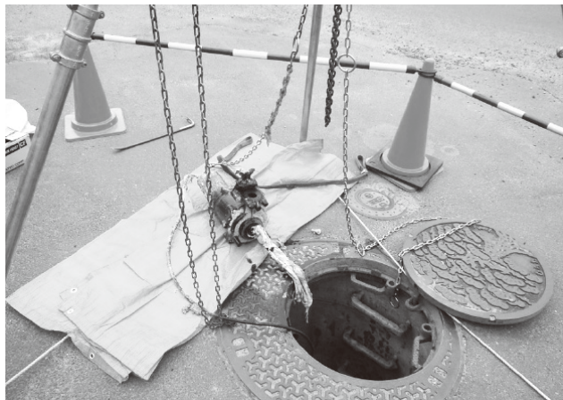
↑タオルがからみ故障した汚水ポンプ
