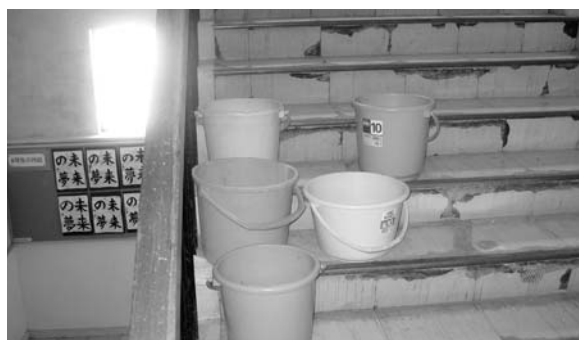
村田第二小学校の雨漏り状況
