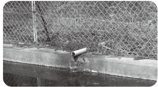
防火水槽への給水管
