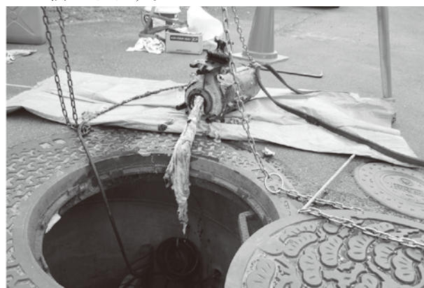
▲汚水ポンプにタオルがからみついている状態
