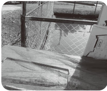
壁がはがれた防火水槽
